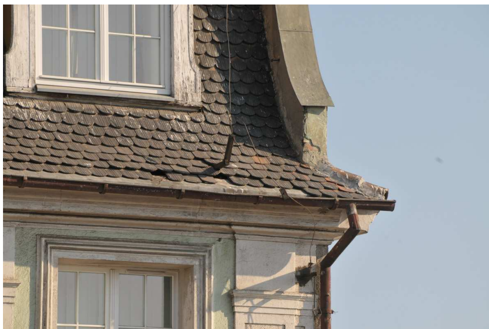
Rysunek 13 – Niepewne i skorodowane połączenie z rynną
