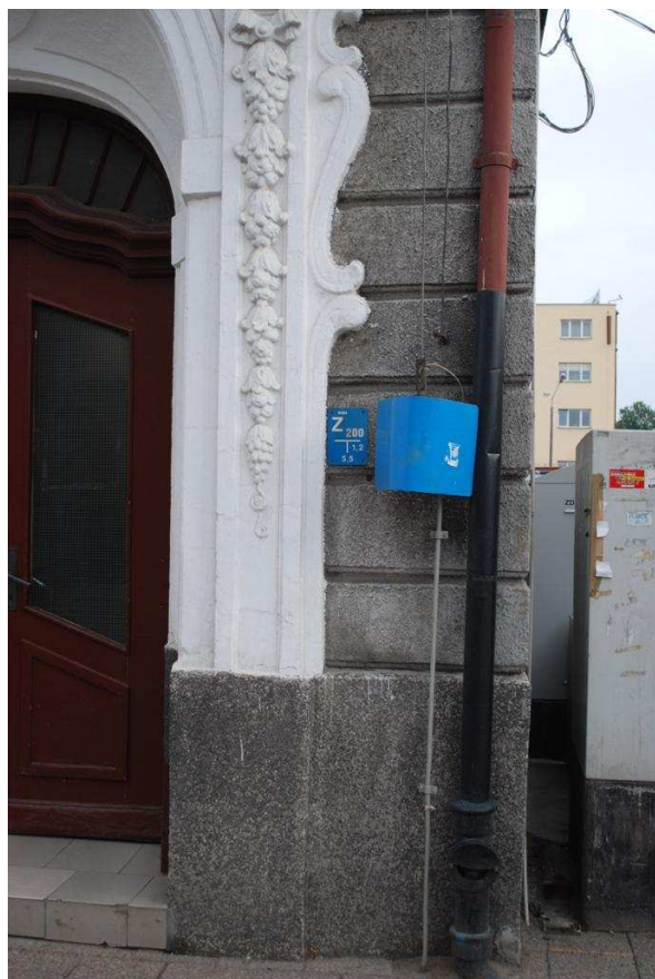
Rysunek 15 - Złącze kontrolne zbyt blisko drzwi wejściowych
