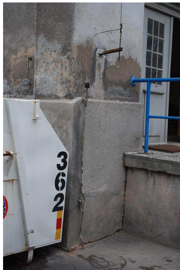
Rysunek 16 - Zły stan przewodu uziemiającego i lokalizacja zbyt blisko drzwi
