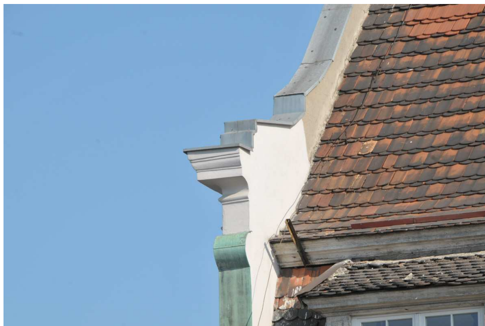
Rysunek 12 - skorodowane uchwyty i brak połączeń z obróbką blacharską
