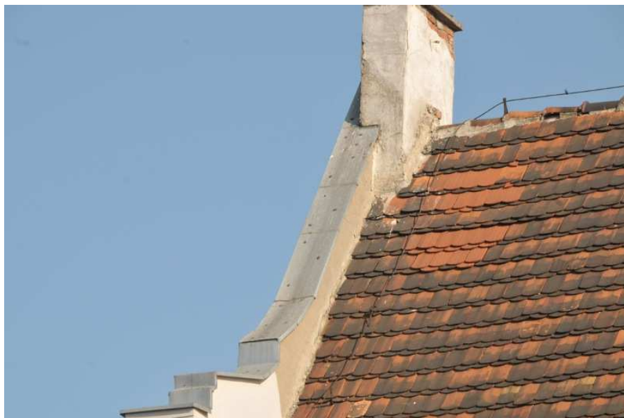
Rysunek 8-Brak połączenia obróbki blacharskiej ze zwodami
