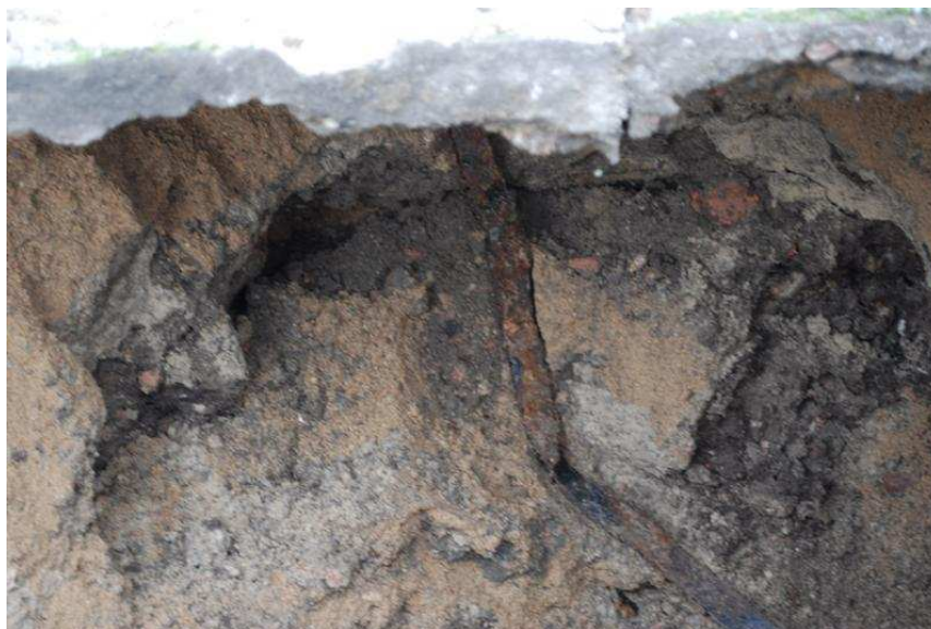
Rysunek 6-Stan przewodu odprowadzającego pograżonego w gruncie
