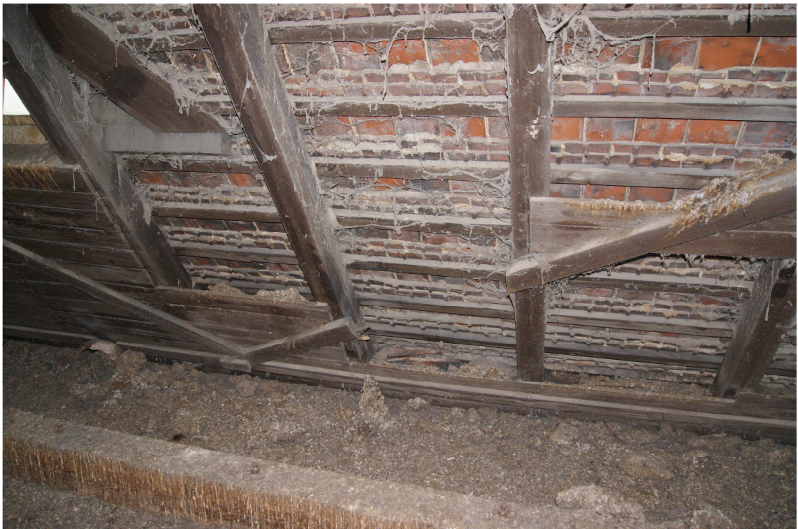
Fot. 4 Zniszczona wiatrownica i braki podbitki
