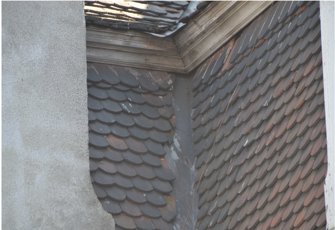
Fot 1. Brak pojedynczych dachówek
