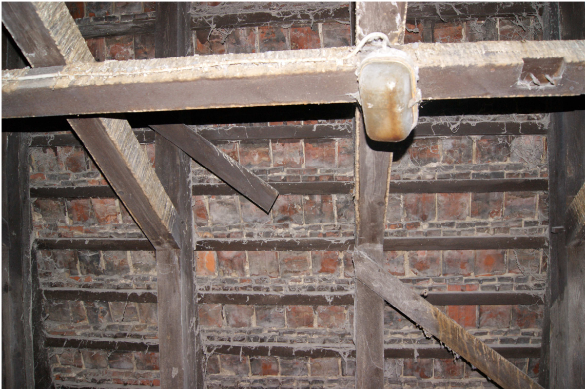
Fot. 3 Zniszczona wiatrownica
