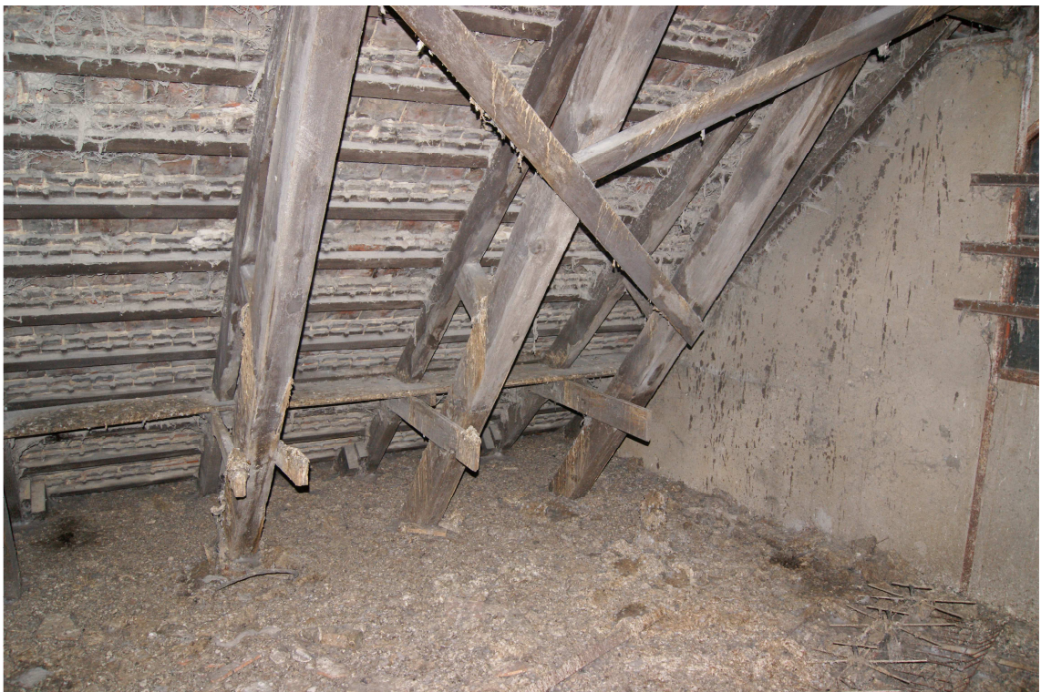
Fot.2 Brak kleszczy
