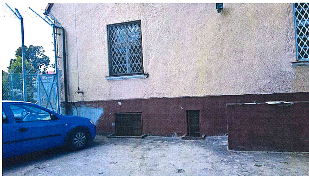
Fot. 4 – cokół elewacji południowej widoczne zaprawione ubytki tynku
