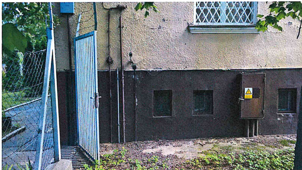
Fot. 10 – elewacja północna - kable
