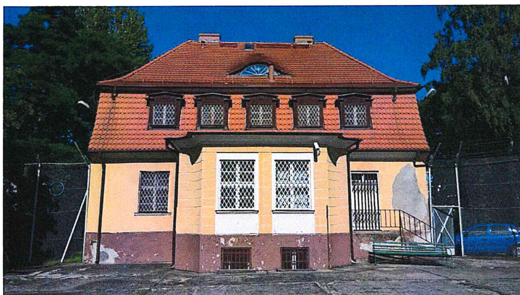
Fot. 11 – elewacja zachodnia – widoczne odparzenia tynku na cokole
