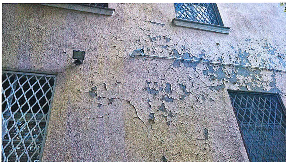
Fot. 9 – elewacja północna – ubytki farby elewacyjnej
