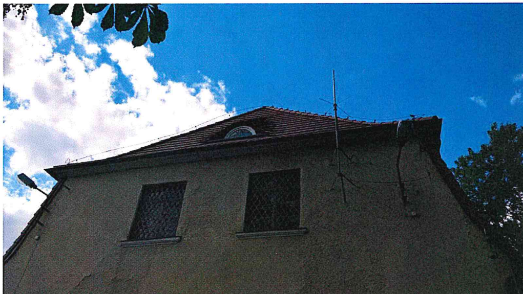
Fot. 3 – elewacja południowa – piętro – widoczne odparzenia i spękania tynku
