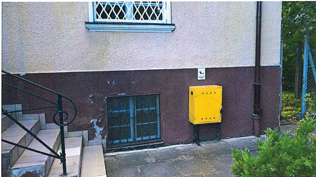
Fot. 15 – skrzynka gazowa na elewacji wschodniej
